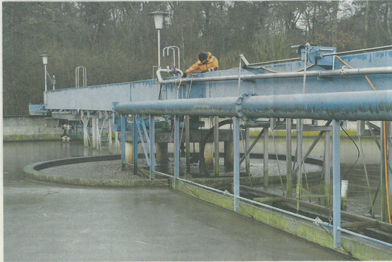
Nicht restlos sauber: Drei Reinigungsstufen durchläuft das Wasser in der Langener Kläranlage.
